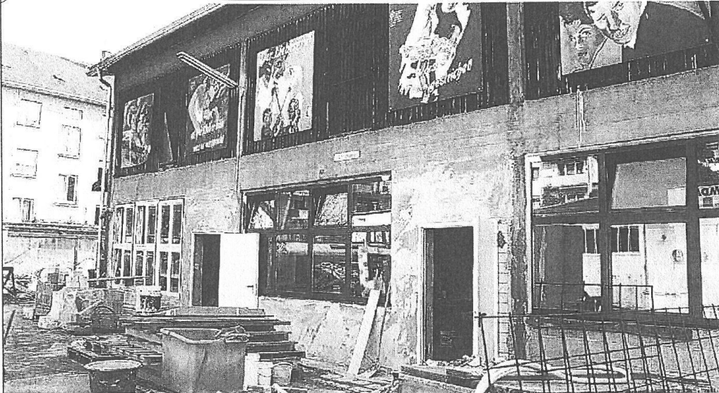
Die "neuen" Fenster, die jetzt in Richtung Kunsthof eingebaut wurden, ließen noch vor einiger Zeit das Tageslicht ins Rathaus und ins Haus der Begegnung (HdB)
