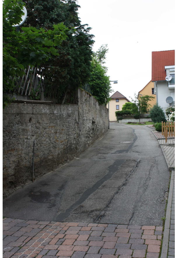
Problemmauer an der Heidelheimer Straße
