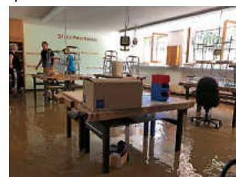
Technikraum – einer der betroffenen Fachräume im Untergeschoss Foto: S. Carra
