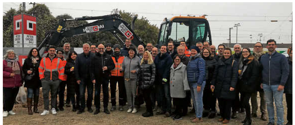
Oberbürgermeisterin Cornelia Petzold-Schick setzte im Beisein vieler Unterstützer/-innen den ersten Baggerbiss für das Großprojekt „Umgestaltung Bahnhofsareal“ Fotos: PSAK
