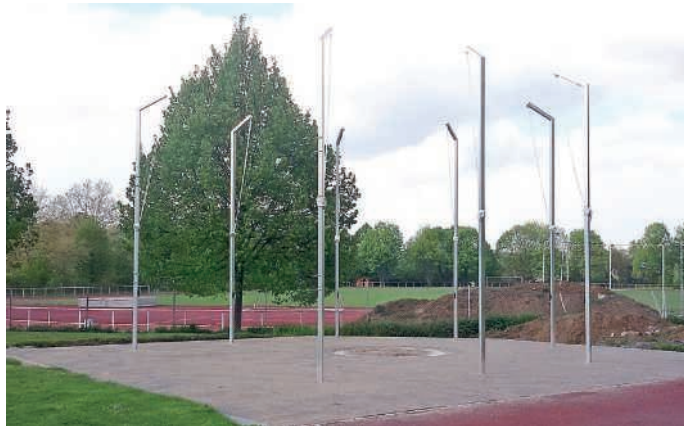
Neue Diskusanlage im Stadion
