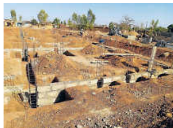
In Burkina Faso werden auf die Fundamentsohle Betonsteine gemauert Foto: St. Souli
