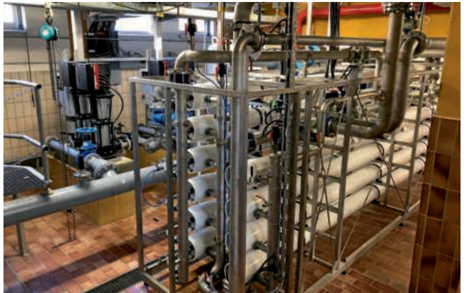
Dank der neuen Niederdruck-Umkehrosmoseanlage im Wasserwerk Heildenheim kommen die Stadtwerke-Kunden in Heildenheim und Helmsheim in den Genuss der bestmöglichen Trinkwassergüte.
