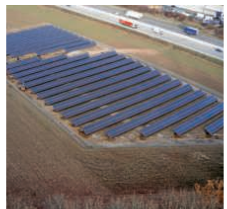
PV-Freiflächenanlage Seelach der BBE Energie GmbH aus der „Drohnenperspektive“
