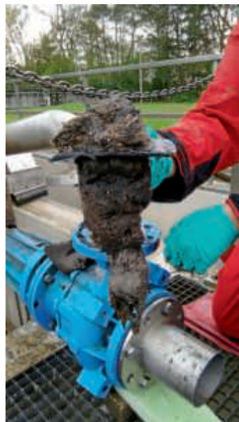
Ablagerungen an Rohren Foto: pm
