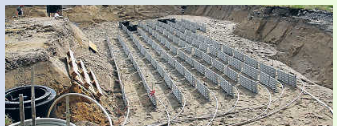
Das Röhren-„Feld“ der oberflächennahen Geothermie Foto: Thomas Hannich
