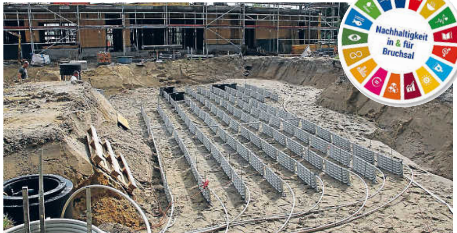
Kollektoren im Boden bringen im Zusammenwirken mit einer Wärmepumpe die Erdwärme in den Kindergarten und das Gemeindehaus. Foto: Thomas Hannich
