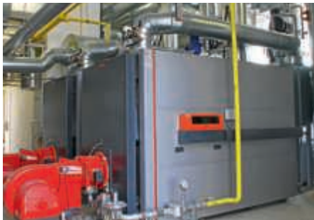
Das Herzstück für die Versorgung der Bahnstadt mit Fernwärme hat sein Zuhause im Alten Umspannwerk, gegenüber der Stadtwerke-Verwaltung.
