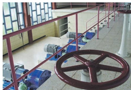
Am 18. Juni kann man sich sowohl über das Bruchsaler Trinkwasser informieren, als auch zu geführten Besichtigungen des Wasserwerks Bruchsal am 21. oder 28. Juli anmelden. Foto: tw
