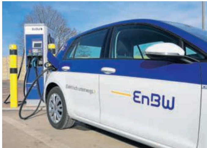
In drei Minuten Strom für 100 Kilometer tanken: Schnelllade-Standorte bringen Elektro-Power in den urbanen Raum sowie an Verkehrsachsen / perspektivisch bis zu acht Ladepunkte pro Standort für gleichzeitiges Schnellladen.
