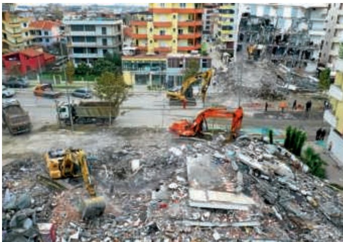
Aufräumarbeiten nach großer Zerstörung durch Erdbeben in Durrës/Albanien Foto: pr
