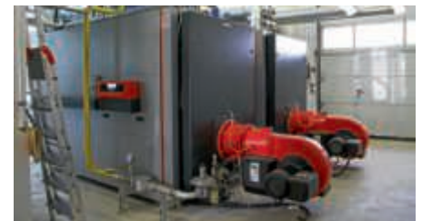
Die Heizentrale im Alten Umspannwerk mit biogasbetriebenen Blockheizkraftwerk und Gasspitzenlastkessel versorgt die Bahnstadt mit Fernwärme. Fotos: SWB | tw
