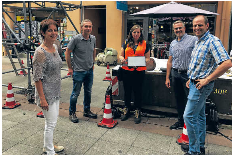
Vor-Ort-Besichtigung bei der Kanalsanierung in der Friedrichstraße: Anette Schmitt (Eigenbetrieb Abwasser), Hubert Basler, Katharina Janosch (beide Vogel Ingenieure), Falk Berger und Bernd Jöchner (beide Eigenbetriebe Abwasser / von links). Foto: PM
