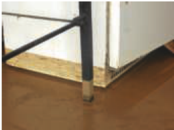
Hochwasserschaden Foto: Huber
