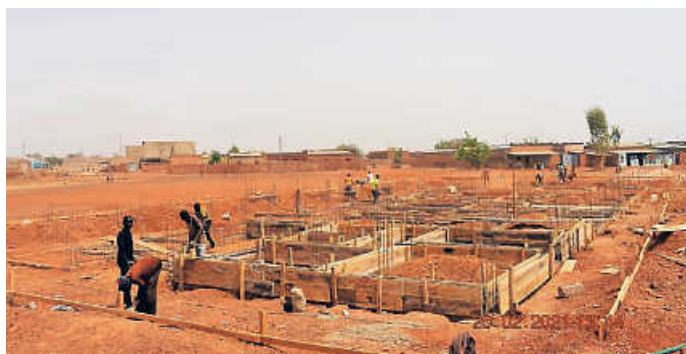
Klinikbau Burkina Faso: Die Arbeiter beim Einschalen für die Betonsockel Foto: St. Souli
