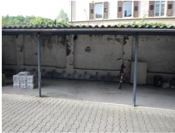
Abb. 8.13: Nicht anforderungsgerechtes Fahrradparken an der Verwaltungsstellen Untergrombach
